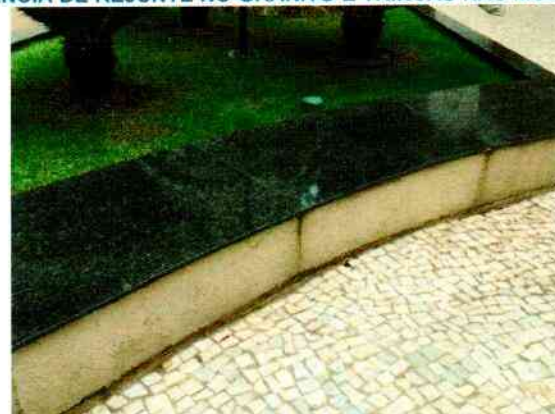
FIGURA 84. AUSÊNCIA DE REJUNTE NO GRANITO E TRINCAS NAS MURETAS DE JARDIM.
