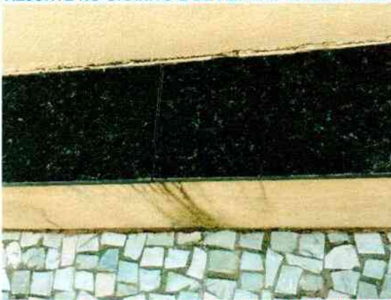
FIGURA 102.AUSÊNCIA DE REJUNTE NO GRANITO E DE REPARO NA JUNTA DA BASE MURETA DE JARDIM.
