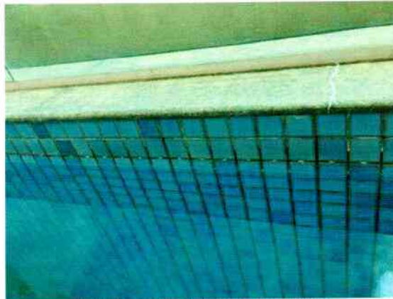
FIGURA 54.AUSÊNCIA DE REJUNTE.
