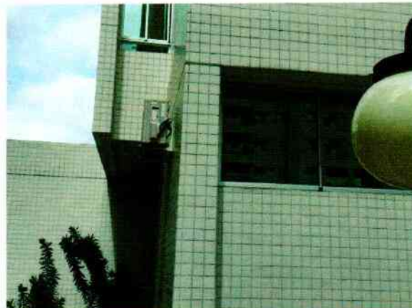
FIGURA 57. APARELHO DE AR CONDICIONADO INSTALADO POSTERIORMENTE.
