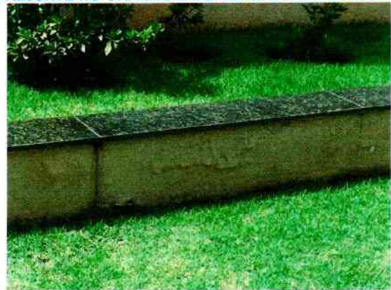
FIGURA 101.AUSÊNCIA DE REJUNTE NO GRANITO E DE REPARO NA JUNTA DA BASE MURETA DE JARDIM.
