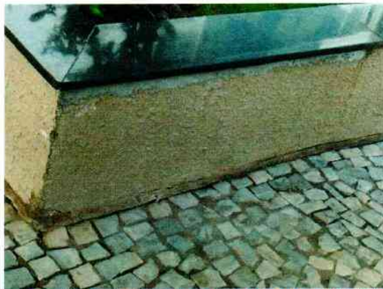
FIGURA 100.AUSÊNCIA DE REJUNTE NO GRANITO E DE REPARO NA JUNTA DA BASE MURETA DE JARDIM.
