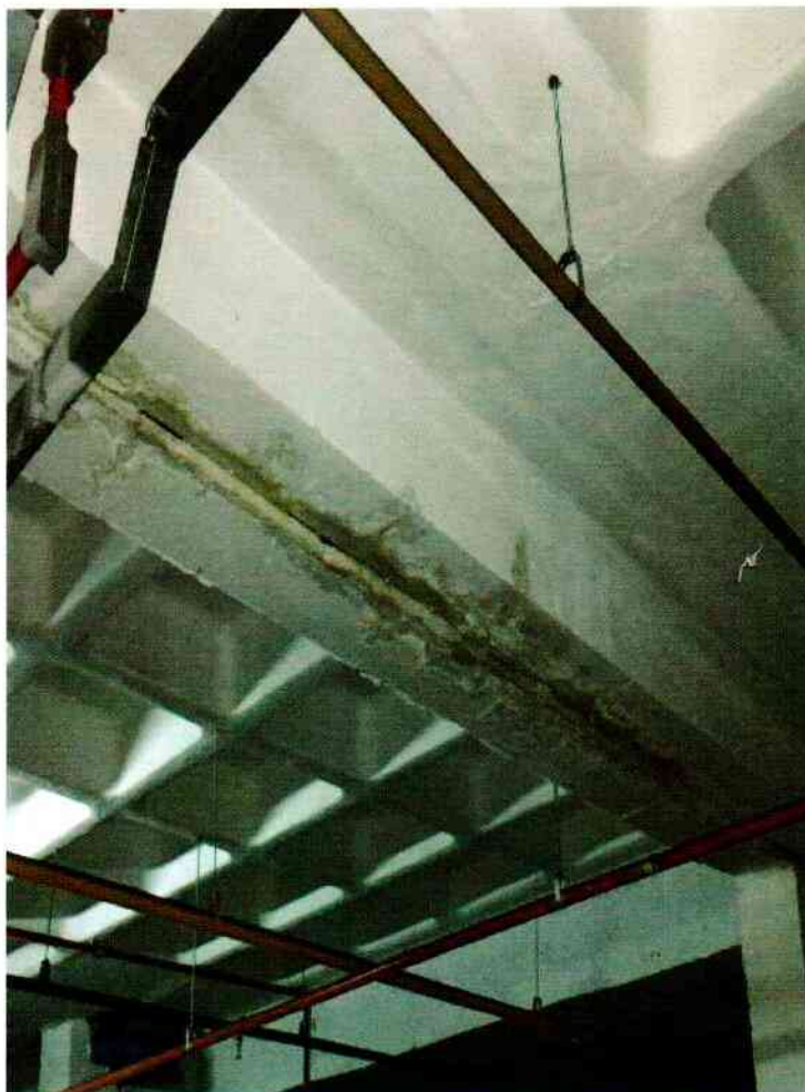
FIGURA 257.PRESENÇA DE UMIDADE.
