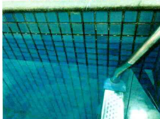
FIGURA 55.AUSÊNCIA DE REJUNTE.
