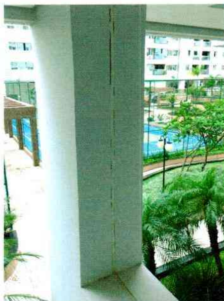
FIGURA 21. JUNTA DE DILATAÇÃO DANIFICADA.
