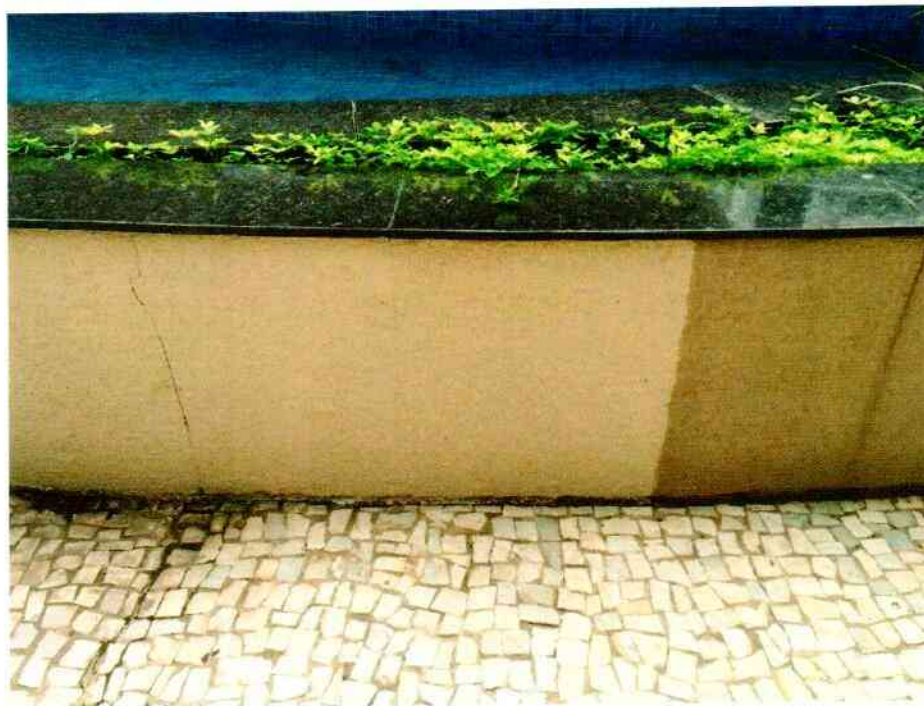
FIGURA 81. AUSÊNCIA DE REJUNTE NO GRANITO E TRINCAS NAS MURETAS DE JARDIM.
