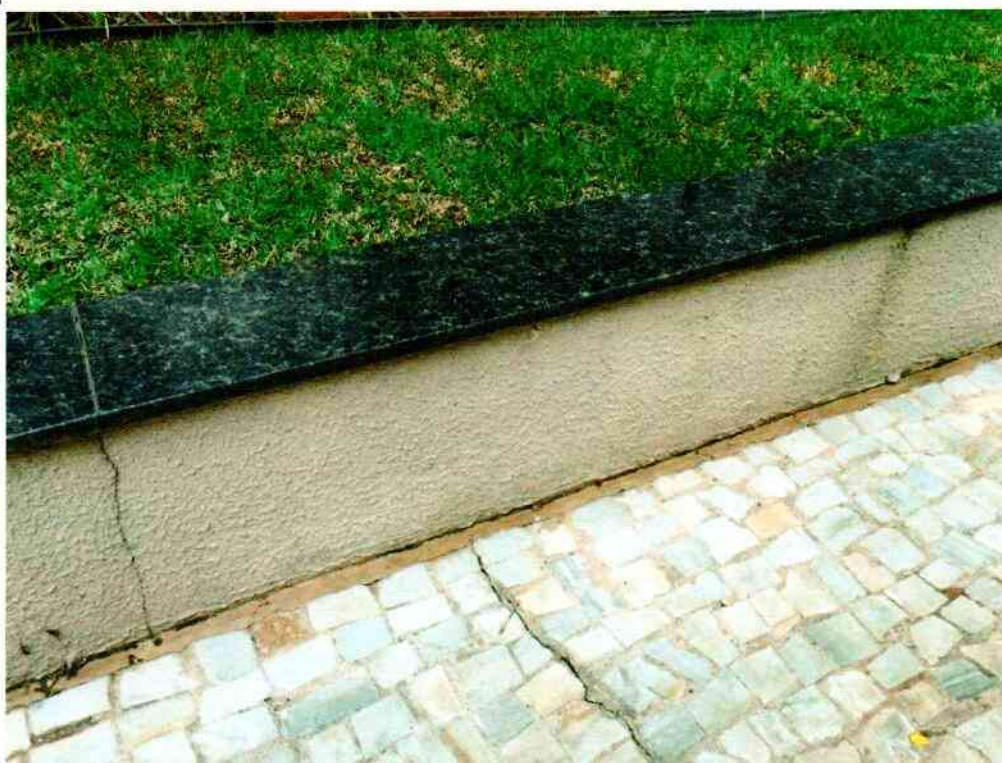
FIGURA 95. AUSÊNCIA DE REJUNTE NO GRANITO E TRINCAS NAS MURETAS DE JARDIM.
