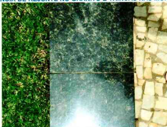
FIGURA 83. AUSÊNCIA DE REJUNTE NO GRANITO E TRINCAS NAS MURETAS DE JARDIM.
