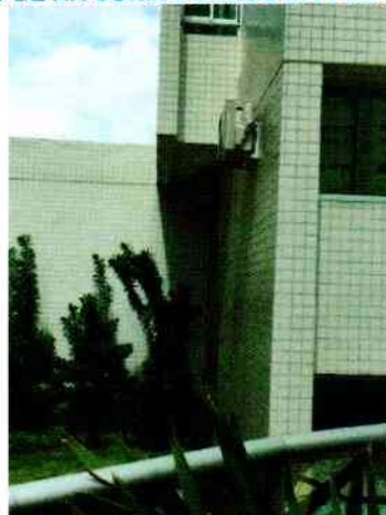
FIGURA 58. APARELHO DE AR CONDICIONADO INSTALADO POSTERIORMENTE.
