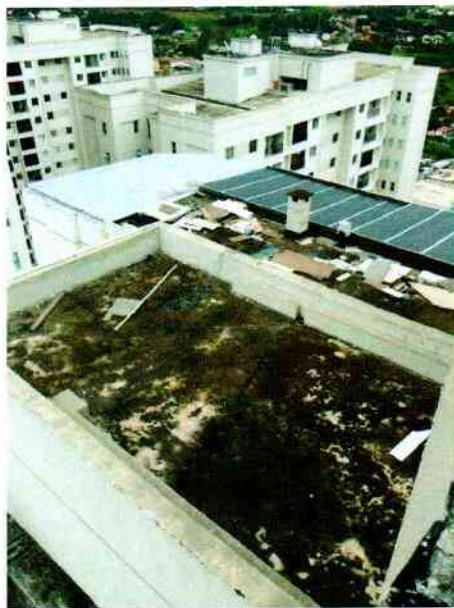
FIGURA 1. ENTULHO NA COBERTURA.
