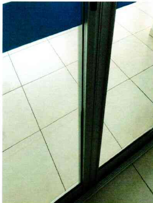
FIGURA 199.BORRACHA DE FIXAÇÃO SOLTANDO.
