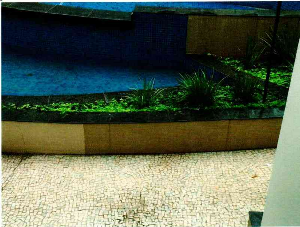
FIGURA 129. AUSÊNCIA DE REJUNTE E TRINCAS NO MURO.
