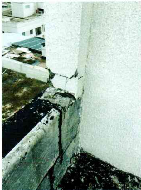
FIGURA 7. TRINCA EM PAREDES.
