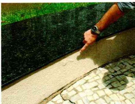
FIGURA 82. AUSÊNCIA DE REJUNTE NO GRANITO E TRINCAS NAS MURETAS DE JARDIM.
