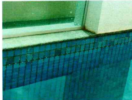
FIGURA 56.AUSÊNCIA DE REJUNTE.
